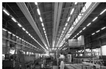
Halle de production avec panneaux rayonnants
