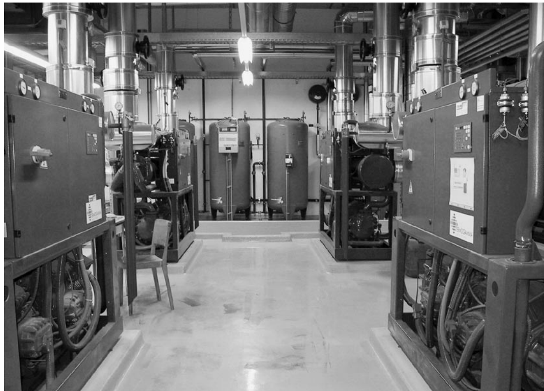
Vue des 4 pompes à chaleur
